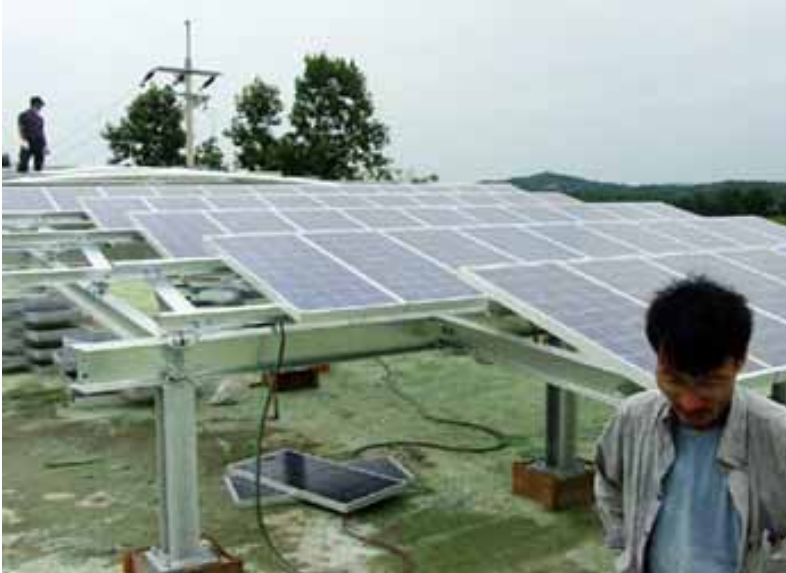
<그림 24> 홍동면의 태양광 발전시설
